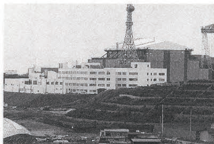
建設開始から7年が過ぎ建屋の鉄骨が錆び付いてきている (9月26日)
